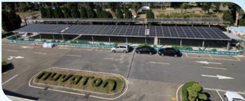
▲ 研新工場駐車場での太陽光パネルの拡張
